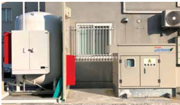
防災設備（左：災害バルク、右：LPガス非常用発電機）
