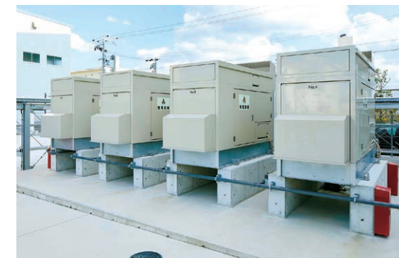
災害対策として導入が進むLPガス非常用発電機
