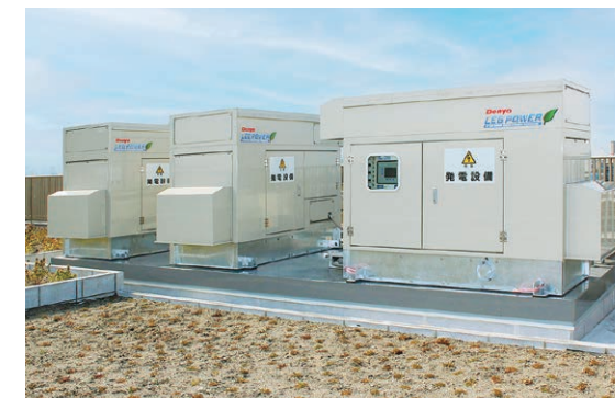
BCP対策として採用が広がるLPガス非常用発電機
