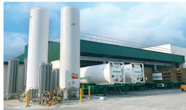
シンガポールにて新設したガスセンター
