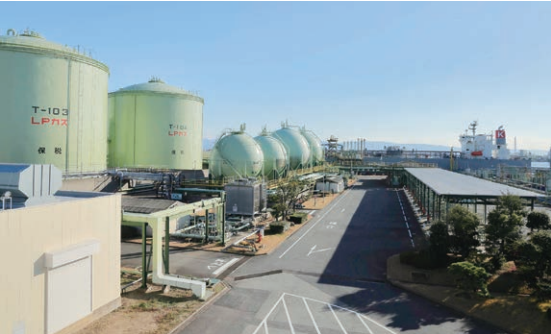
LPガス輸入基地「堺LPGターミナル」
