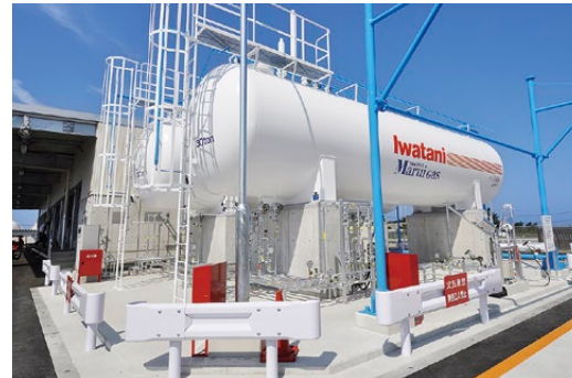
販売が好調な工業用LPガス
