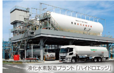
液化水素製造プラント「ハイドロエッジ」
