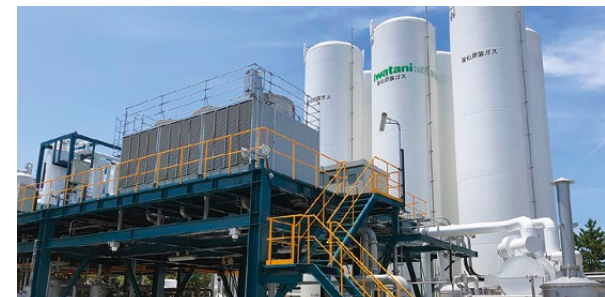
岩谷瓦斯株式会社千葉工場に新設した液化炭酸ガス製造プラント
