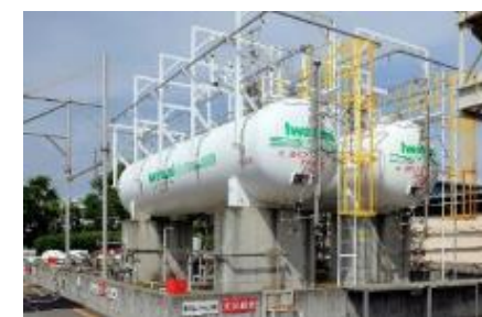
アンモニア設備
