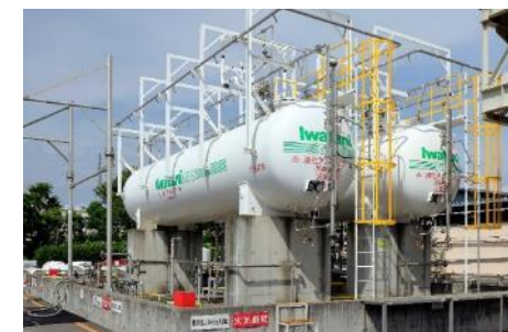
アンモニア設備
