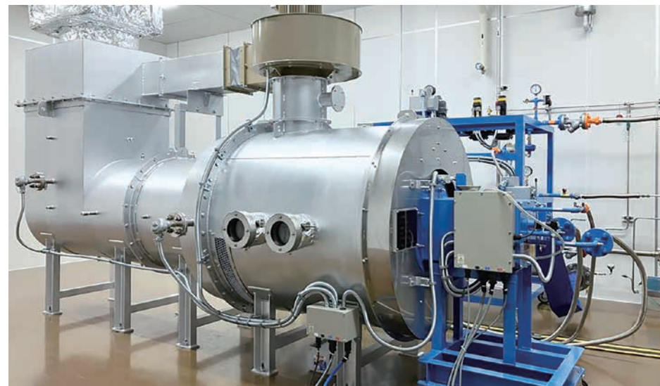
中央研究所に設置した水素混焼・酸素富化燃焼設備
