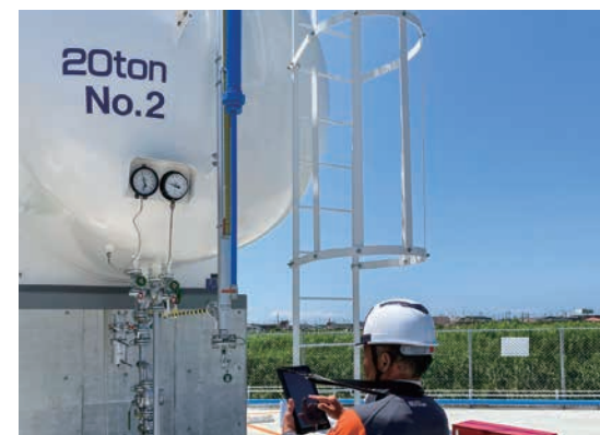
タブレットを活用した工場設備点検
