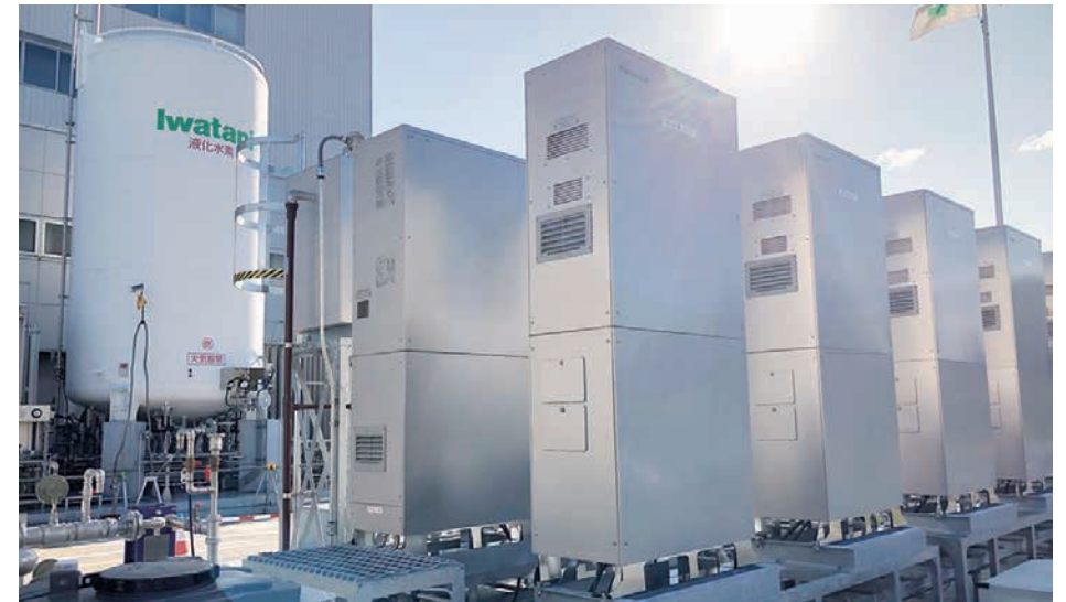
中央研究所に導入した純水素型燃料電池(5kW×20台)
