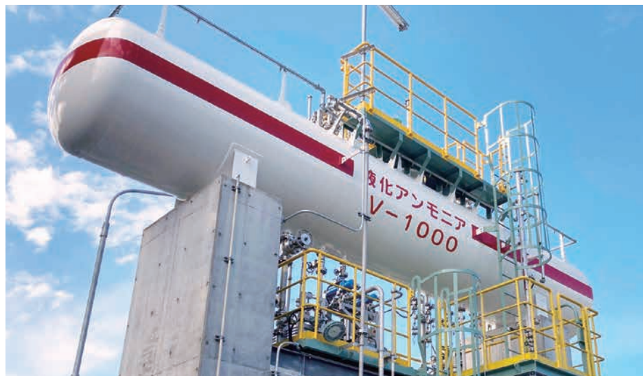
アンモニア混焼用液化アンモニア貯槽
