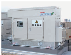
LPガス非常用発電機
