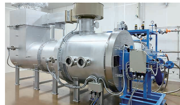
中央研究所に設置した顧客の実証に活用可能な水素混焼バーナー
