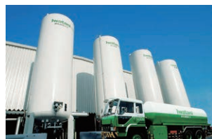
高圧ガス供給設備
