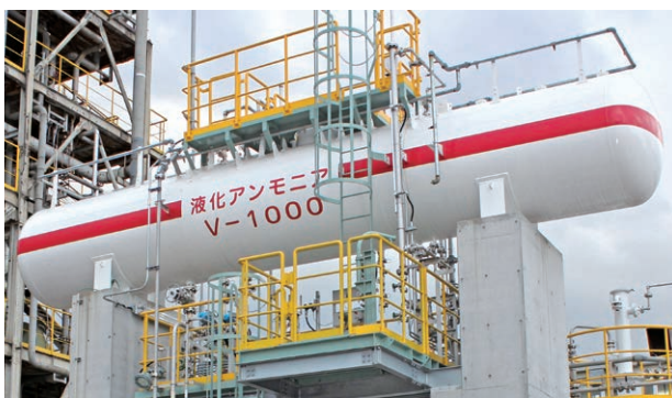
アンモニア供給設備
