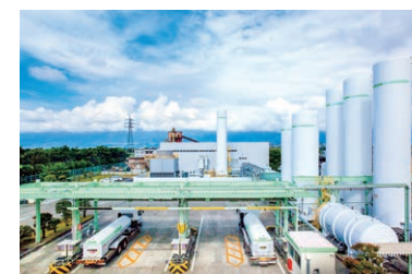
産業ガス製造プラント
