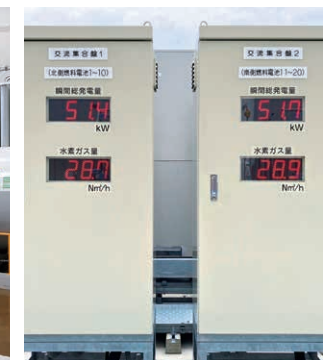
純水素型燃料電池発電設備
