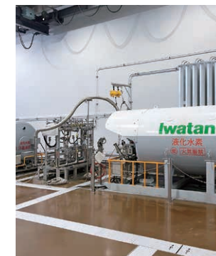
液化水素実験設備
