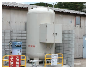
LPガス供給設備
