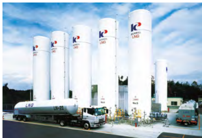
LNGサテライト設備(甲賀エナジー(株))
