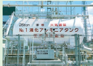
アンモニア供給設備
