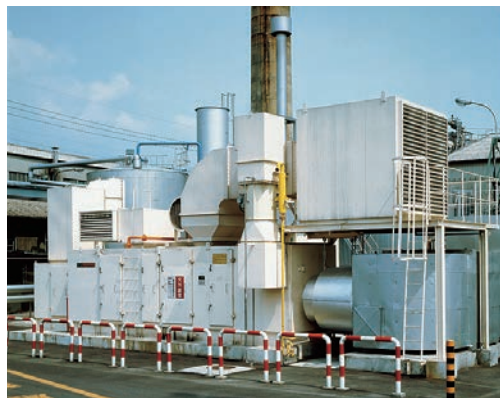
コージェネレーションシステム
