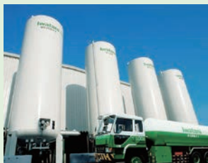
高圧ガス供給設備
