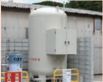
LPガス供給設備
