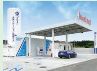
水素ステーション関連設備
