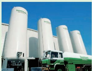
高圧ガス供給設備
