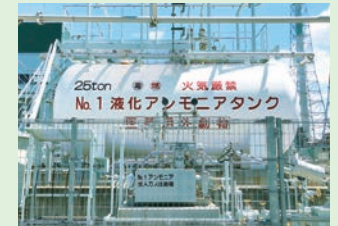
アンモニア供給設備
