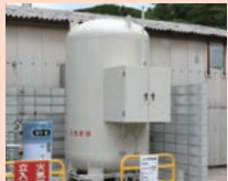
LPガス供給設備
