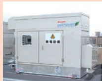
LPガス非常用発電機
