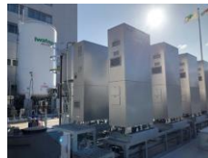
中央研究所の燃料電池設備
