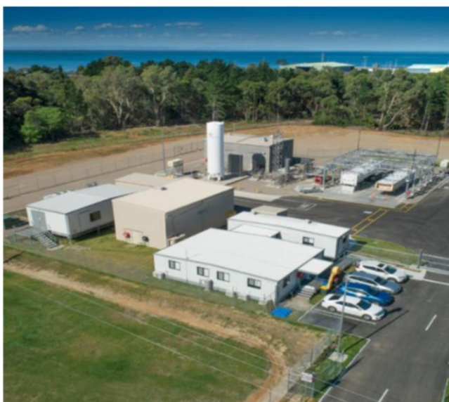
豪州側の水素液化・積荷基地
