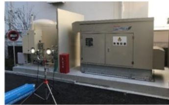
LPガス非常用発電機とLPガス災害バルク
