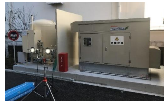
LPガス非常用発電機とLPガス災害バルク
