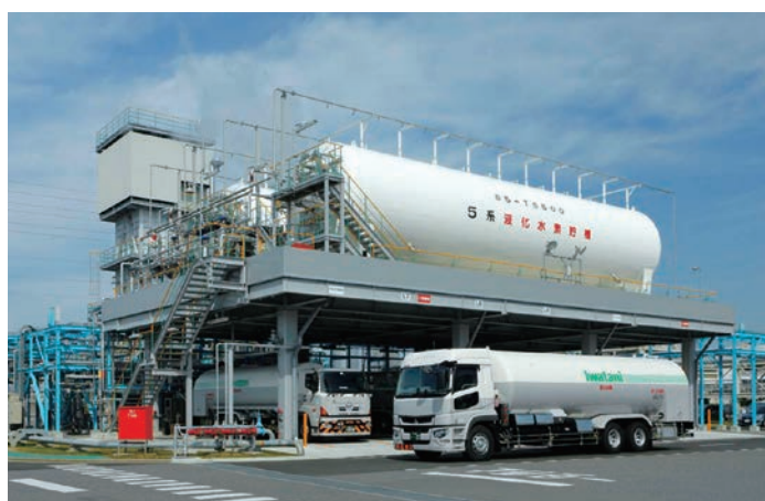
液化水素製造プラント「ハイドロエッジ」
