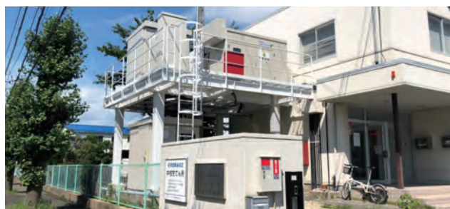
受電設備と非常用発電機を2m以上の高さに設置(郡山LPGセンター)
