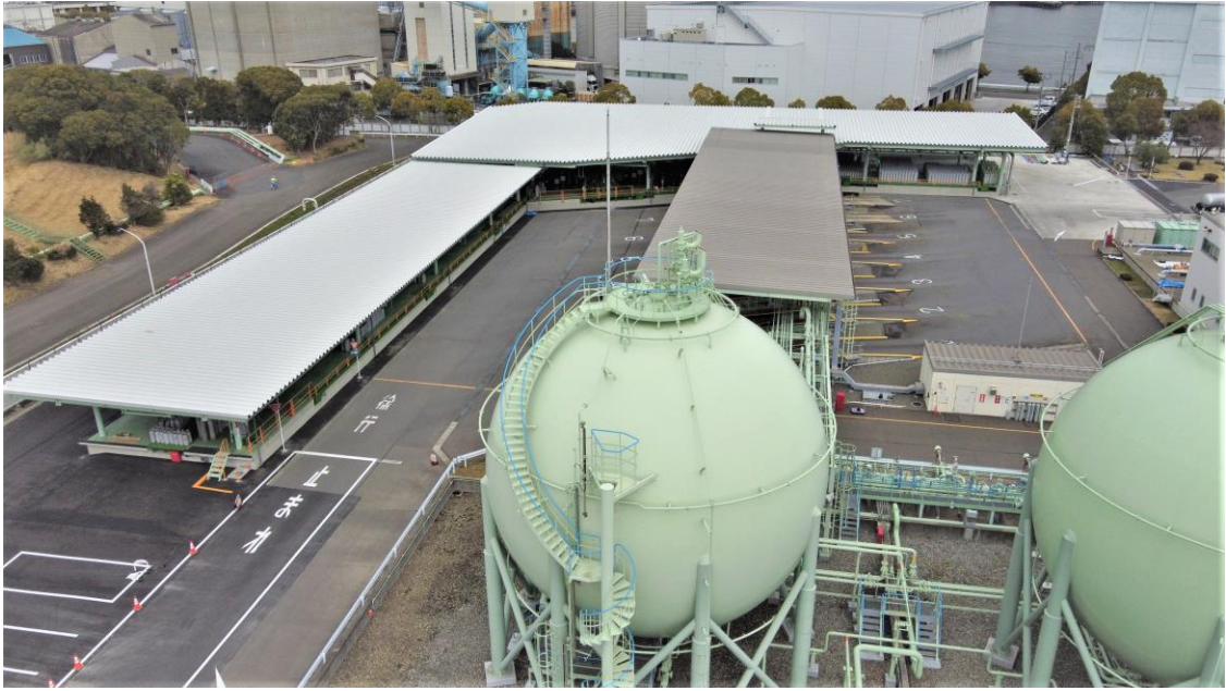
新設のLPGシリンダー充填所（奥側）と既設球形タンク・ローリー出荷設備（手前側）
