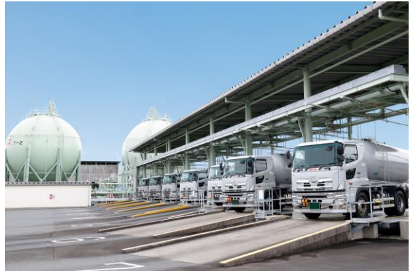
600tLPGタンク×2基とローリー出荷設備
