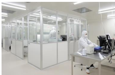
クリーンルーム
