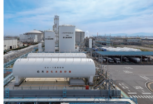
大阪府堺市の液化水素製造プラント「ハイドロエッジ」
