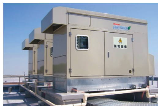
販売が好調なLPガス非常用発電機
