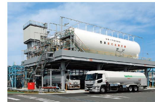
製造能力の増強を行った液化水素製造プラント「ハイドロエッジ」
