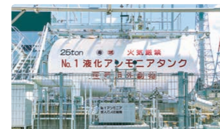
アンモニア供給設備
