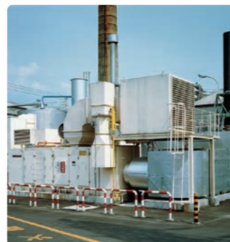
コージェネレーションシステム
