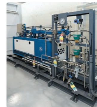
超高压圧縮機・高段圧縮機
