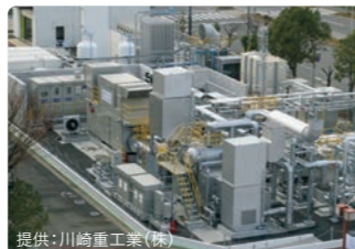
提供:川崎重工業(株) 神戸スマコミ水素発電写真(ポートアイランド) [NEDO助成事業(実施者:(株)大林組・川崎重工業(株))]
