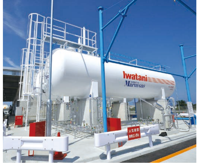
災害に強い「LPG基幹センター」
