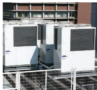
GHP(ガスヒートポンプエアコン)
