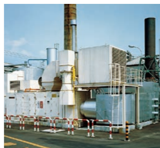
コージェネレーションシステム
