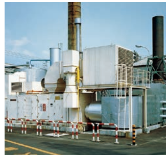
コージェネレーションシステム
