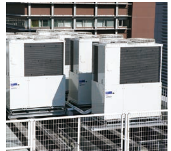
GHP(ガスヒートポンプエアコン)
