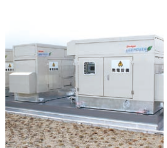
LPガス非常用発電機
