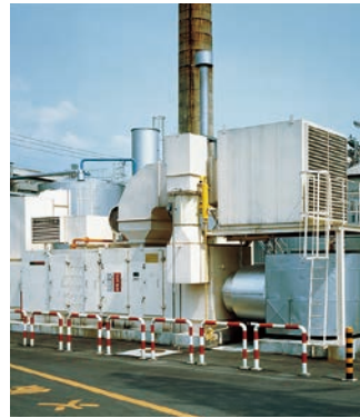
コージェネレーションシステム
