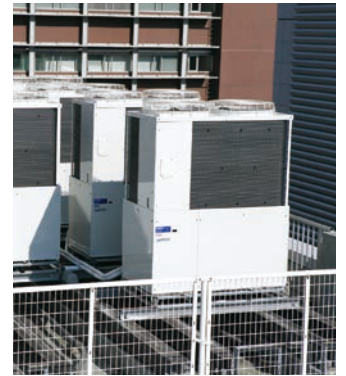
GHP(ガスヒートポンプエアコン)
