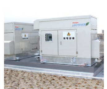
LPガス非常用発電機
