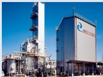
ガス製造プラント
