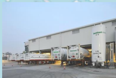
既設のヘリウムセンター
