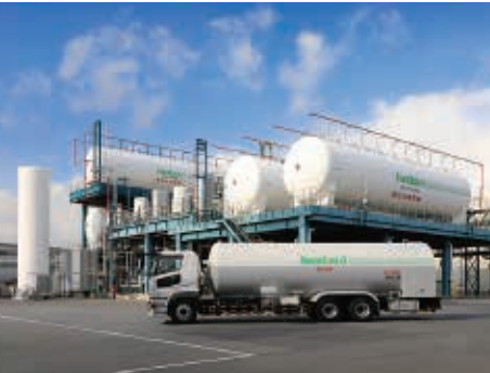
製造能力倍増工事が完了した 山口リキッドハイドロジェン(株)
