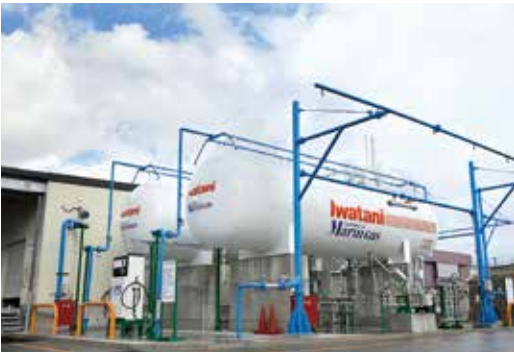
全国で整備が進む災害対策を実施したLPガス基幹センター
